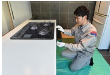
機器設置の様子
