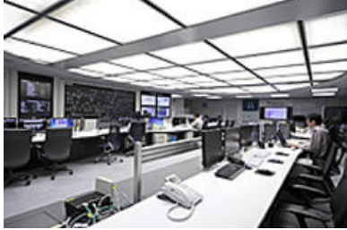
供給指令センター
