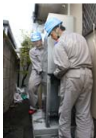
機器設置の様子
