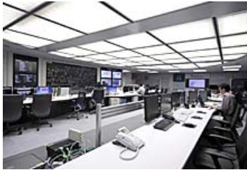
供給指令センター
