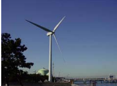
袖ヶ浦LNG基地内の風力発電設備
