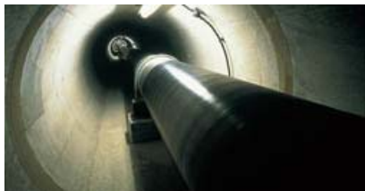
高圧ガス導管
