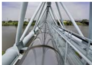
高圧ガス導管
