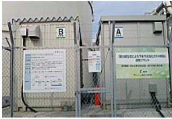
横浜市北部汚泥資源化センターに設置したバイオガス精製試験装置
