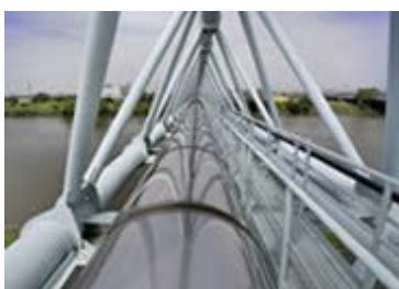
高圧ガス導管
