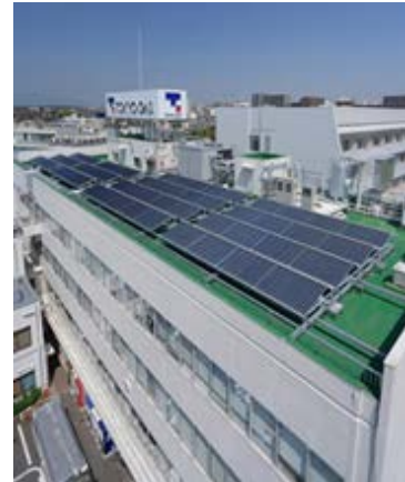
ソーラークーリングシステム (東京ガス湘南ビル屋上)
