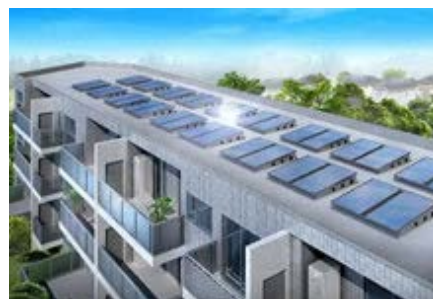
集合住宅の屋上に設置した「SOLAMO」の集熱器
