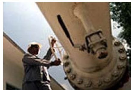
パイプのバルブを操作するガスマレーシア社員
