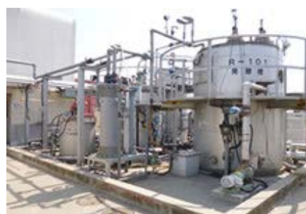
研究所構内に設置したメタン発酵パイロットプラント
