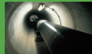
高圧ガス導管
