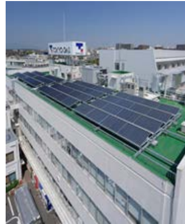
ソーラークーリングシステム（東京ガス湘南ビル屋上）
