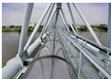
高圧ガス導管
