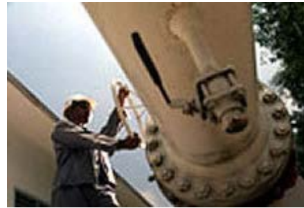
パイプのバルブを操作するガスマレーシア社員
