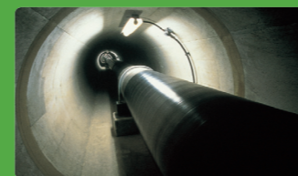
高圧ガス導管
