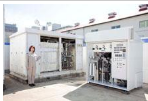
水素分離型改質器システム（左）とCO 2 分離回収装置（右）
