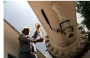
パイプのバルブを操作する ガスマレーシア社員
