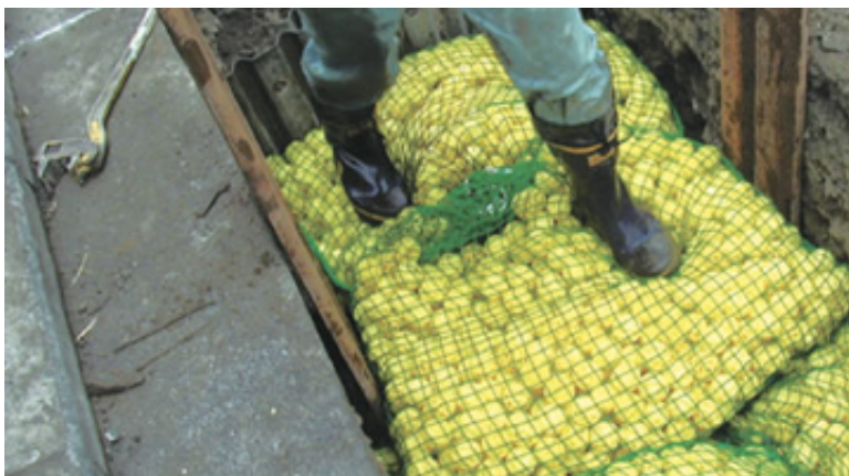
同一箇所を再掘削する場合に新型仮埋め戻し材「ECOボール」を採用し、土砂の利用を低減させています
