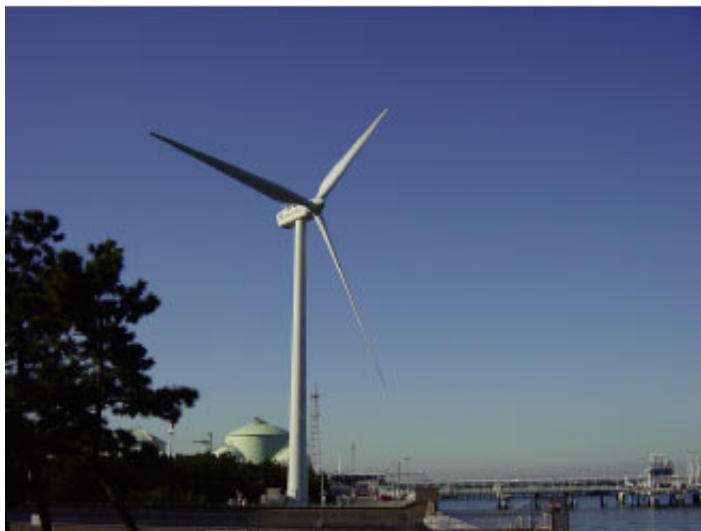
袖ヶ浦工場内の風力発電設備
