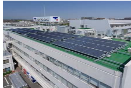
ソーラークーリングシステム (東京ガス湘南ビル屋上)
