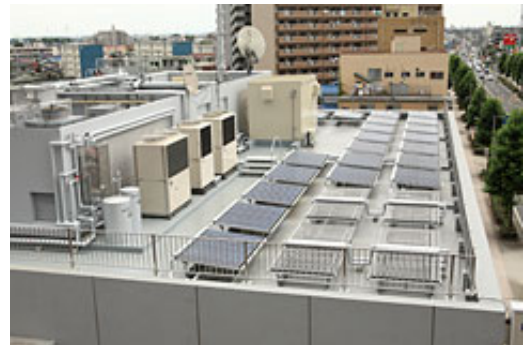
太陽光発電（熊谷ビル）
