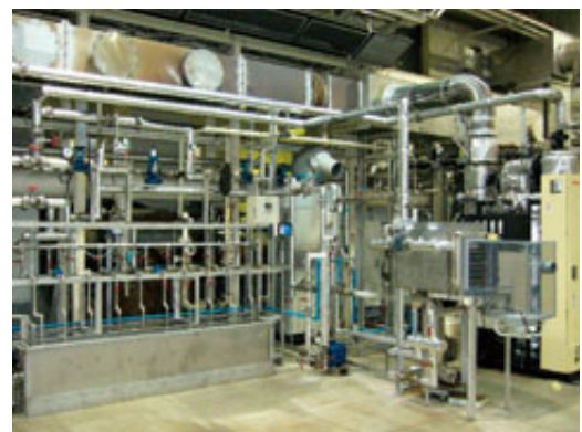
東京ガス千住テクノステーション「スチームステーション」
