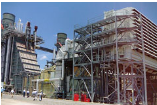
メキシコ パヒオ発電所
