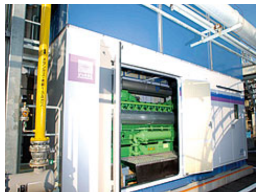
バイオガスを使用したガスエンジン
