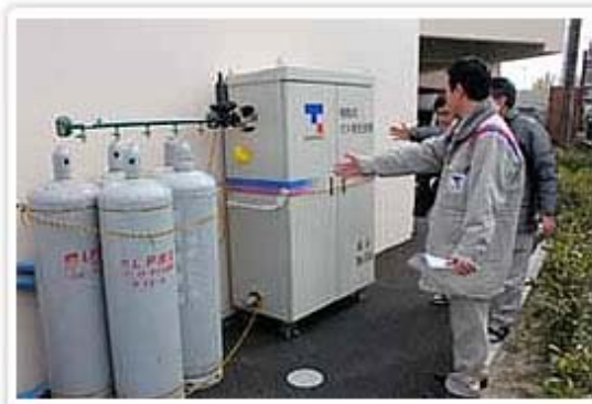
優先支援需要家の病院に「移動式ガス発生設備」を設置。これにより人工透析用の給湯系統が使用可能となった。
