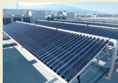
イオンモール甲府昭和様に設置された「ソーラークーリングシステム」
