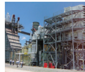
メキシコ パヒオ発電所
