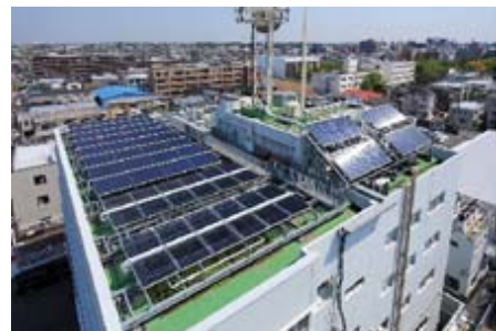
高効率ソーラー空調システム (東京ガス中原ビル屋上)
