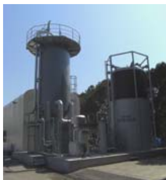
江東区に設置されたバイオガス回収実験施設の一部。 メタン発酵槽とガスホルダー
