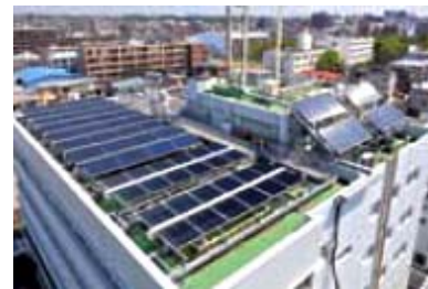
東京ガス中原ビルでの実証実験の様子
