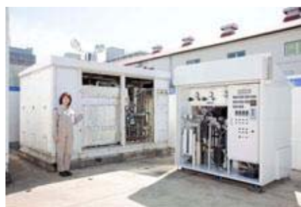
水素分離型改質器システム(左)と CO 2 分離回収装置(右)
