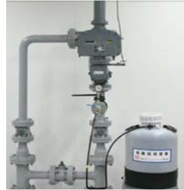
ガス吸着回収システム
