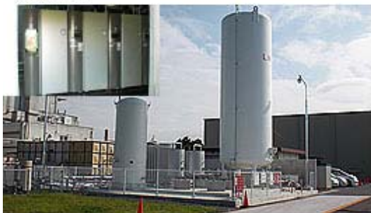
<LNGサテライト>
