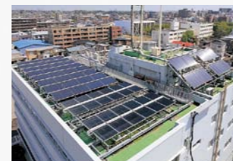
東京ガス中原ビルでの実証実験の様子
