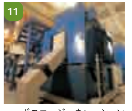
ガスコージェネレーションシステム
