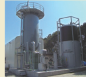
江東区に設置されたバイオガス回収実験施設の一部。メタン発酵槽とガスホルダー
