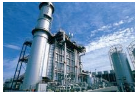
(株)東京ガスベイパワー袖ヶ浦発電所
