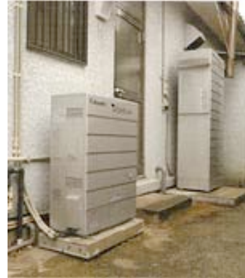
エネファームの設置例
