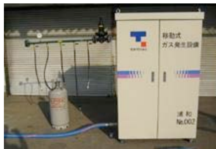
移動式ガス発生設備
