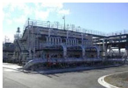
LNG気化器（袖ヶ浦工場）
