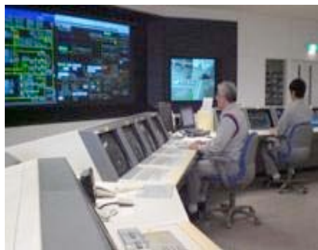
扇島工場コントロールセンター
