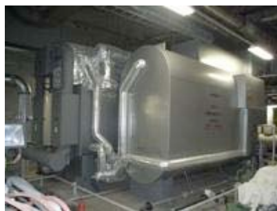
リプレースされたガス吸収冷温水機
