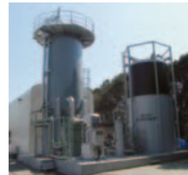
乾式メタン発酵システム実証試験設備
