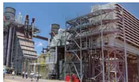
メキシコ パヒオ発電所
