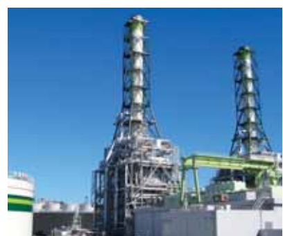
川崎天然ガス発電(株)
