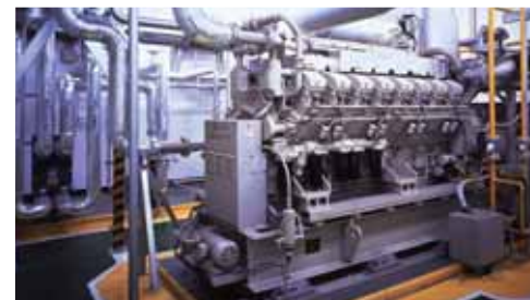
浜松町本社ビル導入と同機種の天然ガスエンジンコージェネレーションシステム 〔写真提供:三菱重工エンジニアリングシステム(株)〕
