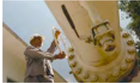
パイプのバルブを操作するガスマレーシア社 社員
