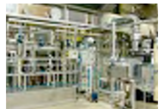
東京ガス千住テクノステーション「スチームステーション」
