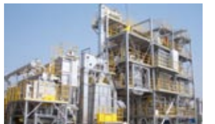
下水汚泥ガス化プラント
