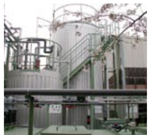
メタン発酵ガス化プラント
