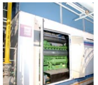
バイオガスを使用したガスエンジン
