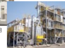
下水汚泥ガス化プラント
