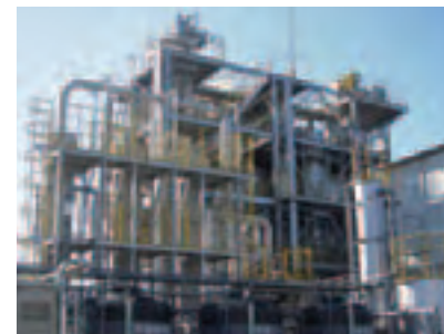
下水汚泥ガス化プラント
