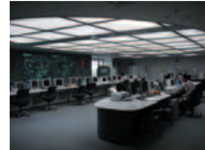
供給指令センター
