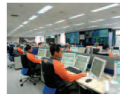
緊急保安業務支援システム(保安指令センター)
