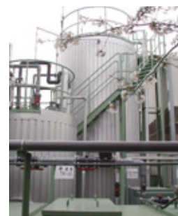
メタン発酵槽
