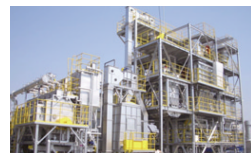
ガス化プラント
