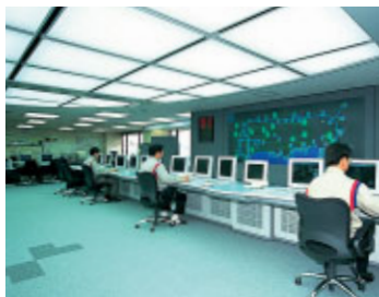
供給指令センター
