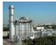
(株)東京ガスバイパワー 袖ヶ浦発電所
