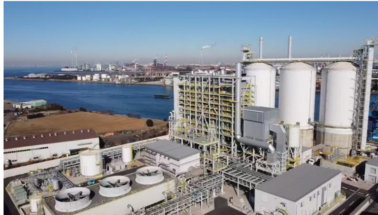
発電所の全景
