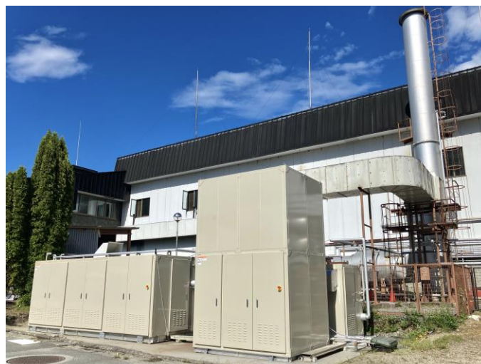
CO 2 分離・回収装置
