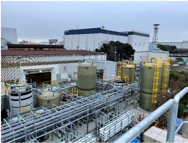
用地課題を解決するコンパクト化を実現した排水処理設備
