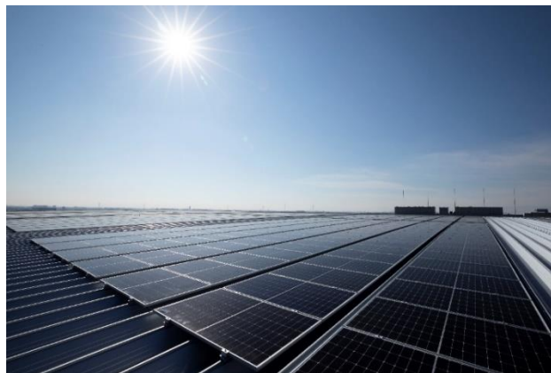
「T-LOGI久喜」屋上太陽光パネル
