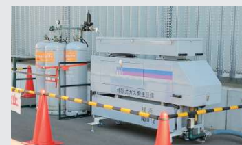
移動式ガス発生設備
