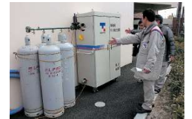
優先支援需要家の病院に「移動式ガス発生設備」を設置。これにより人工透析用の給湯システムが使用可能となった。
