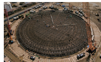
Niihama LNG Terminal
