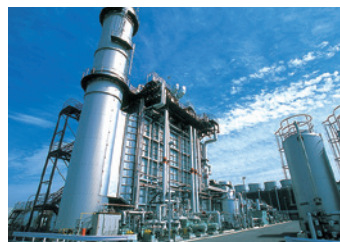
Tokyo Gas Baypower Co., Ltd.
