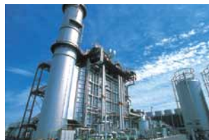
2 Tokyo Gas Baypower Co., Ltd.
