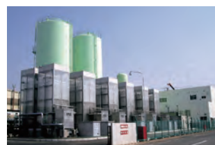
LNG satellite terminal
