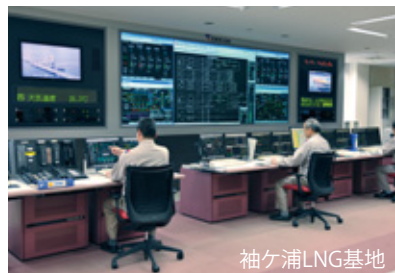
袖ヶ浦LNG基地
