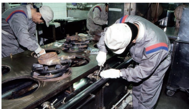
天然ガスに転換するための熱量変更作業（1972年開始）
