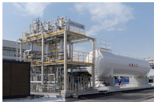
横浜テクノステーションのメタネーション実証設備
