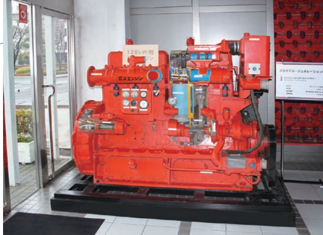
国立競技場に導入された日本初のガスコージェネレーションシステム
