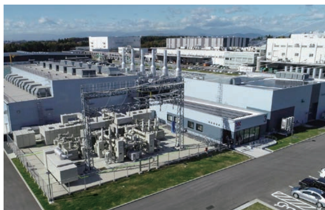
清原スマートエネルギーセンター（栃木県）
