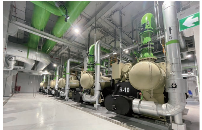
「One Bangkok」のプラントに設置した世界最高水準の高効率冷凍機
