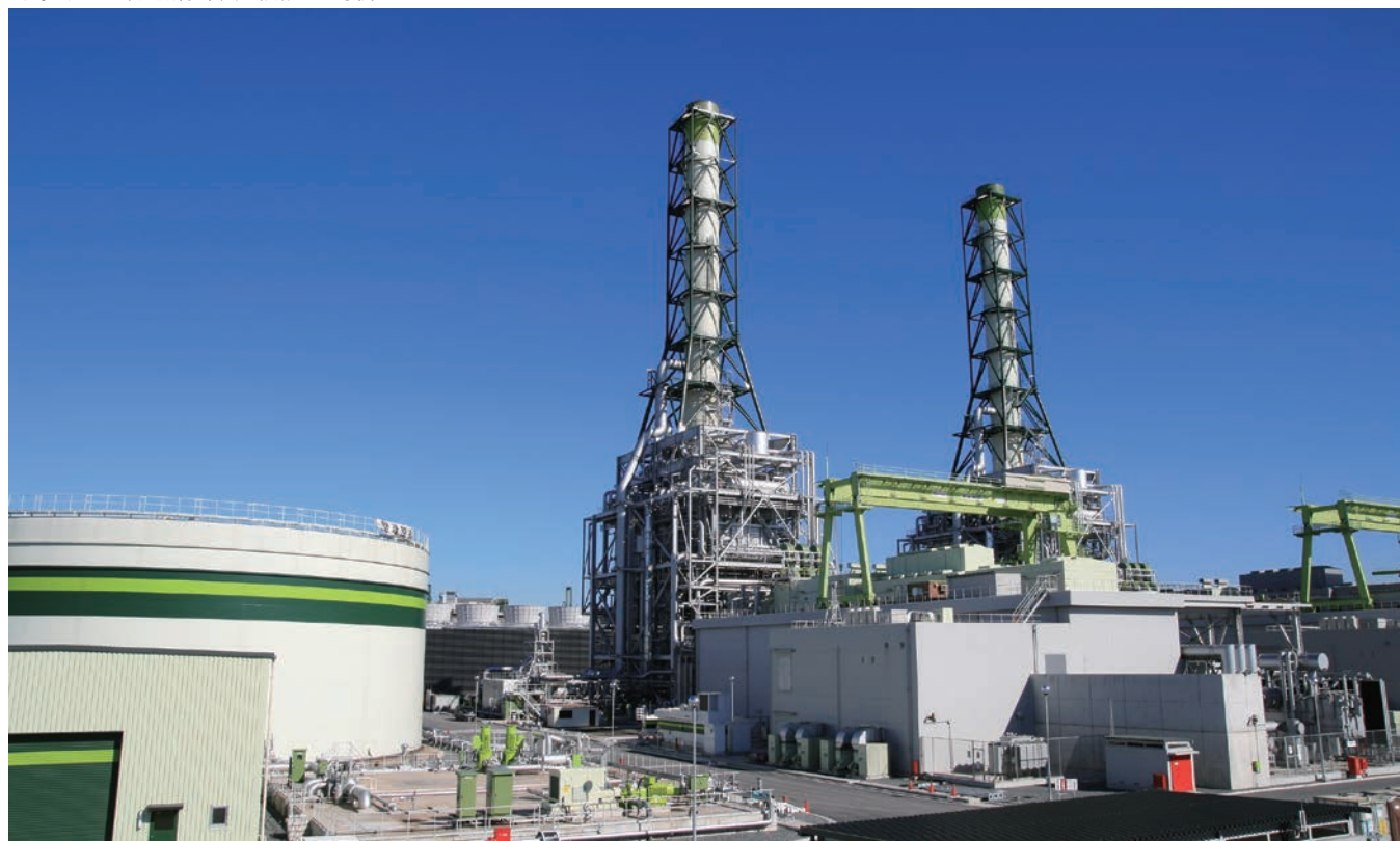
川崎天然ガス発電所。中央の設備が1号機
