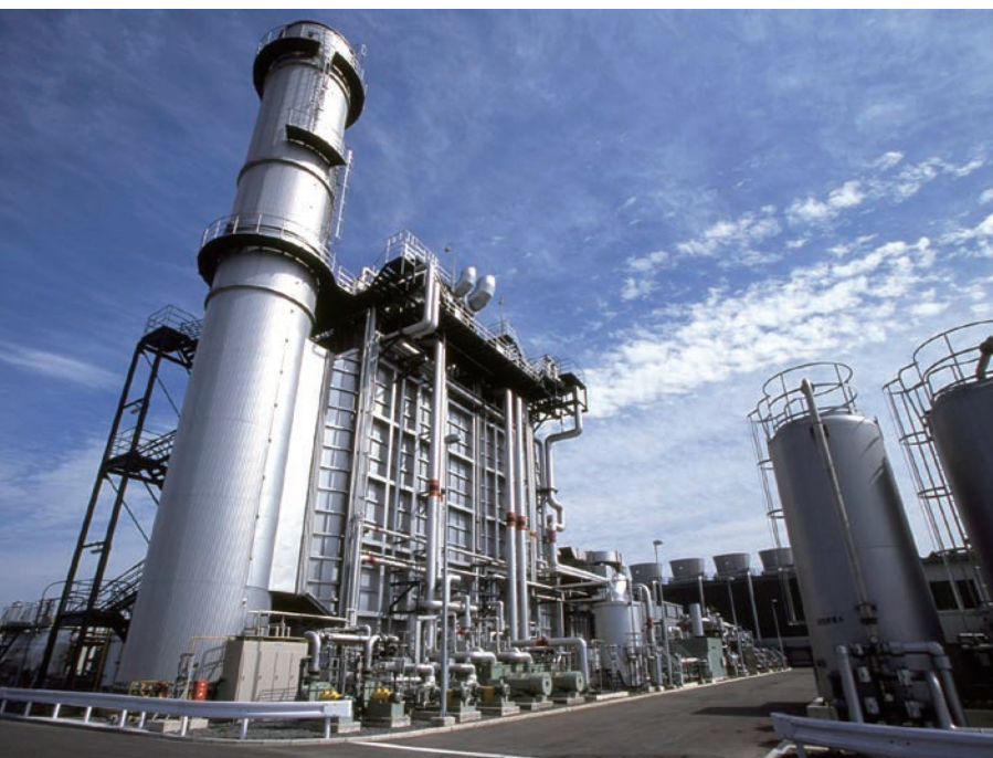
袖ヶ浦工場内に建設された東京ガスベイパワー発電所(2003年10月営業運転開始)
