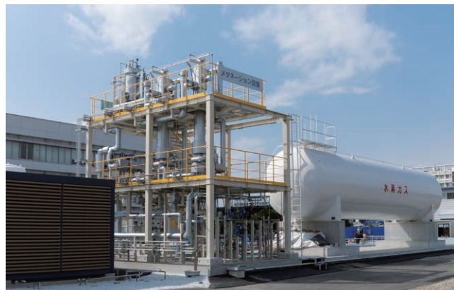
東京ガス横浜テクノステーションで実証試験を開始（2022年3月）
