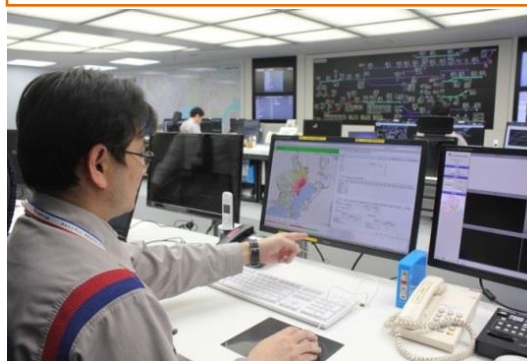
ガス供給の遠隔監視を行う 供給指令センター
