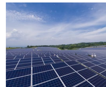
再エネ導入事例:安中市太陽光発電所
