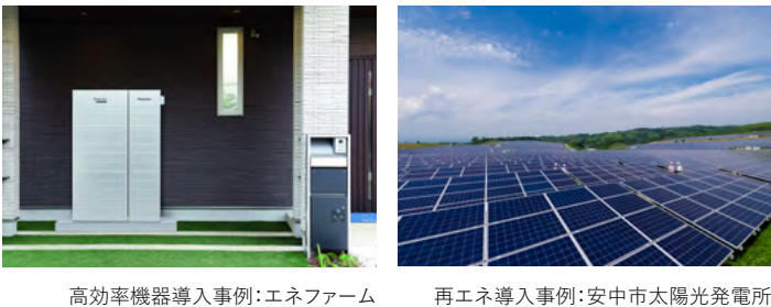
高効率機器導入事例：エネファーム 再エネ導入事例：安中市太陽光発電所
