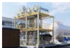
メタネーション設備
