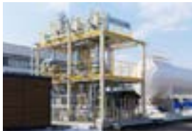
メタネーション設備
