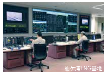
袖ヶ浦LNG基地
